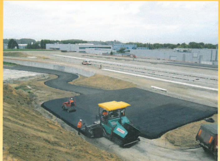
Da das Testgelände in vielen relativ kurzen Abschnitten hergestellt wurde, war der Fertiger trotz der großen Gesamtfläche im Alleingang unterwegs. Dabei durfte er während des Einbaus nicht stehen bleiben, eine perfekt organisierte Baustellenlogistik war ein Muss
