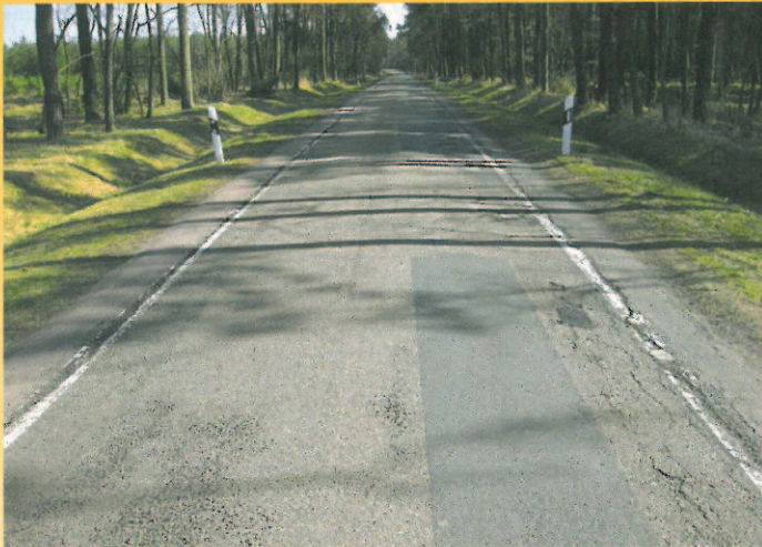
Bild 1: Oberflächenzustand der Landesstraße L 72/L 113 vor der Erneuerung
