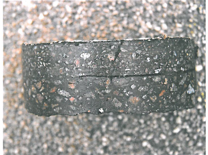
Bild 6: fehlender Schichtenverbund (Quelle: Dudenhöfer)
