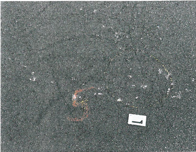
Bild 5: gerissene Gussasphaltoberfläche infolge fehlenden Schichtenverbundes (Quelle: Dudenhöfer)
