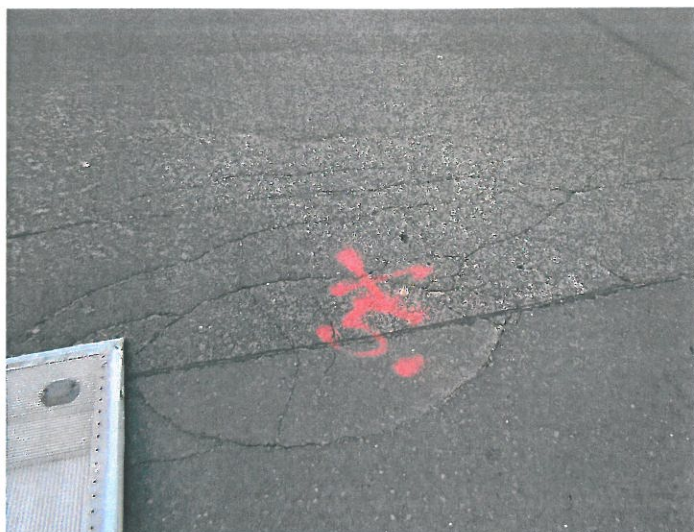
Bild 7: gerissener Gussasphalt mit 3 - 4 cm Asphaltbinder-Profilausgleich auf flexibler Pflasterbefestigung
